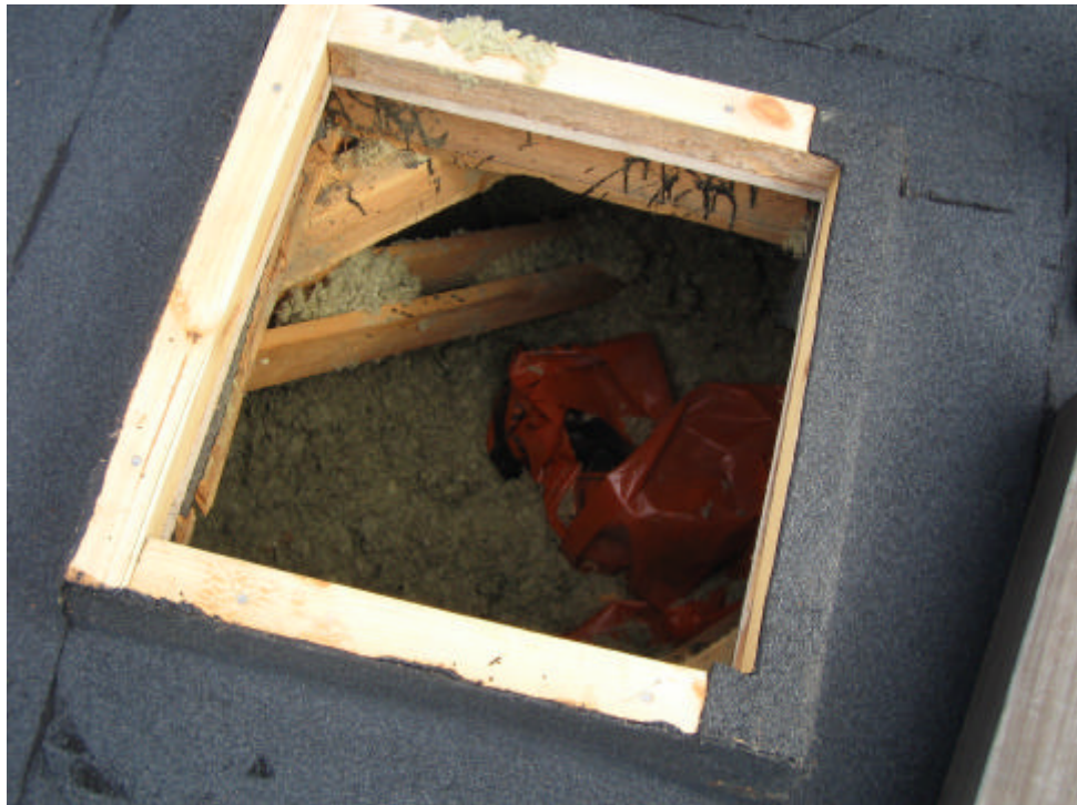
KUVIO 20. Käyntiluukku välikatolle
